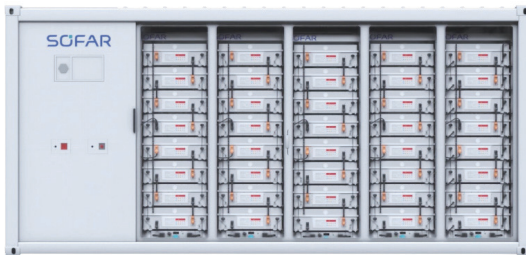
Szafa na akumulator
